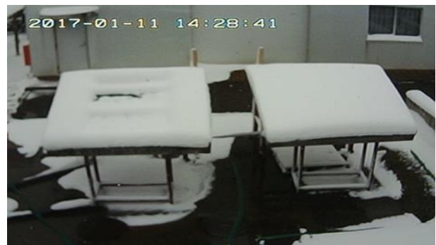
写真 1. 9 A 通電後 6 時間 6 分経過時の様子
