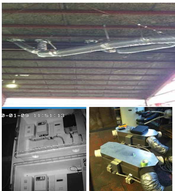
写真2 屋根裏のダクト、温度センサー、熱交換機
