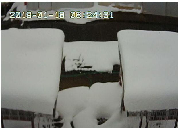
写真 1. 通電開始 19 分後の様子
