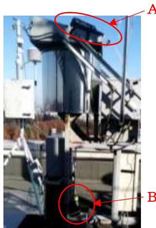
図1 集熱器の設置状況
